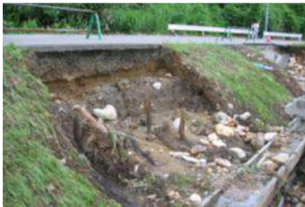
道路法面の崩壊状況
