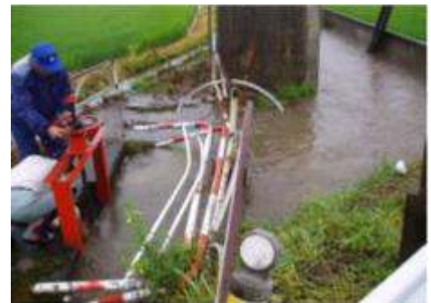
ゲートへのごみや流木の流入状況
