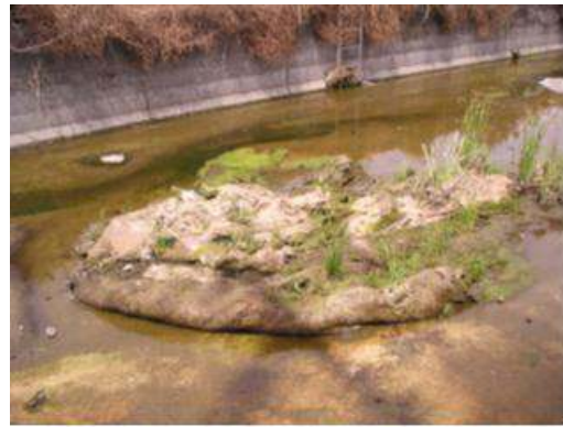
土砂の堆積状況
