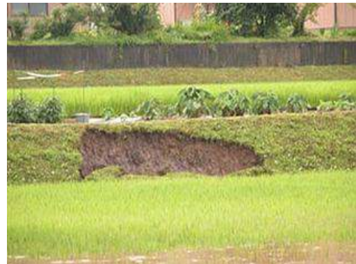
法面の崩壊状況
